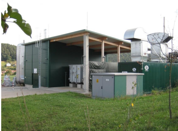
Heizwerk Unterrospehe mit Trafostation, Biogas-Blockheizkraftwerk, offenem Hallenteil für Holzhackschnitzel-Rollcontainer und geschlossenem Hallenteil der Biomassefeuerungsanlage sowie 60 m 3 -Pufferspeicher.
